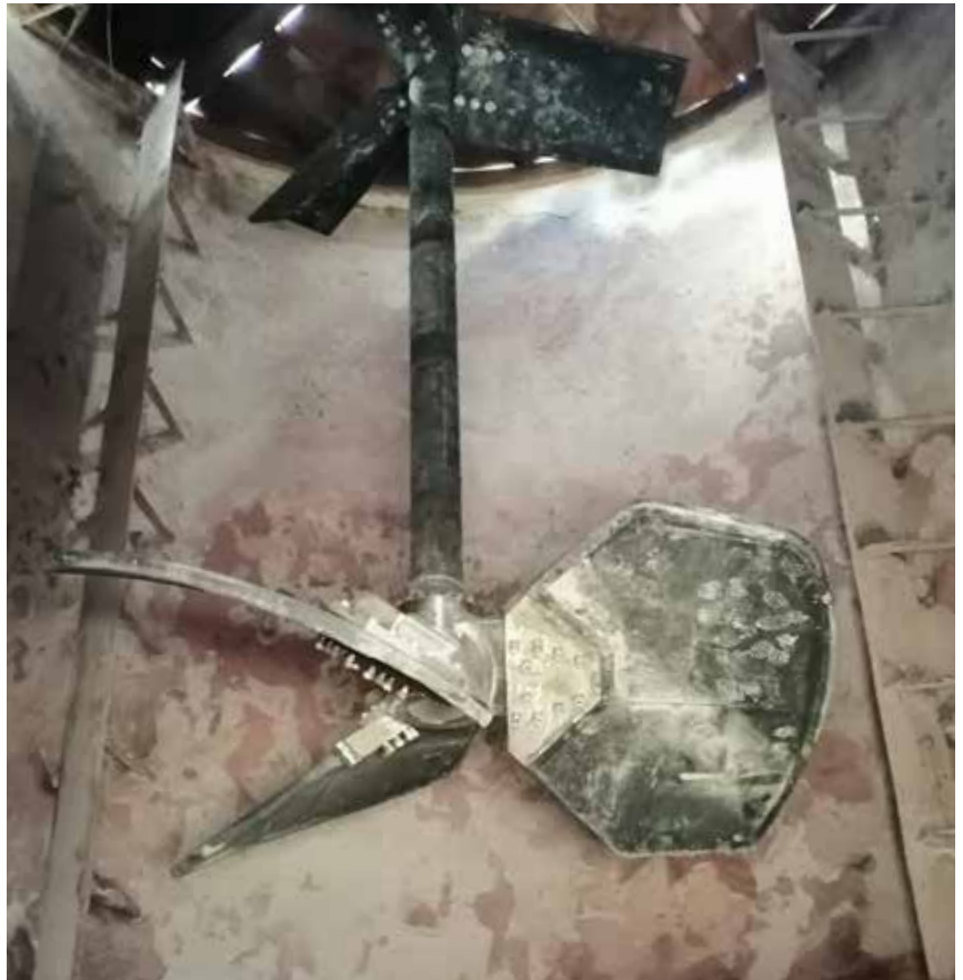
Equipamento com 250HP instalados e grande impelidor Hydrofoil do tipo AH construído em AISI316 e revestidos com neopreno.
