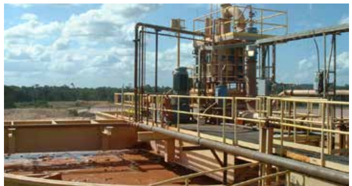
Agitadores com 200 HP, em tanque de lixiviação de ouro com 16m de diâmetro.
